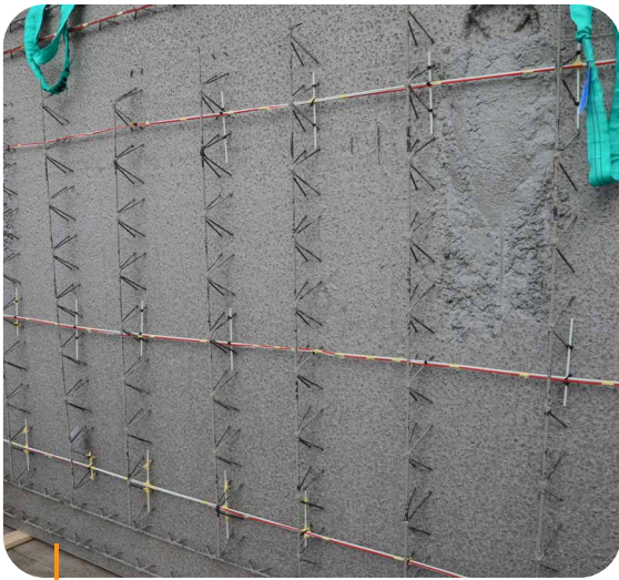
Detail van de bevestiging van de optische vezel meetkabels op het geprefabriceerde betonelement.
